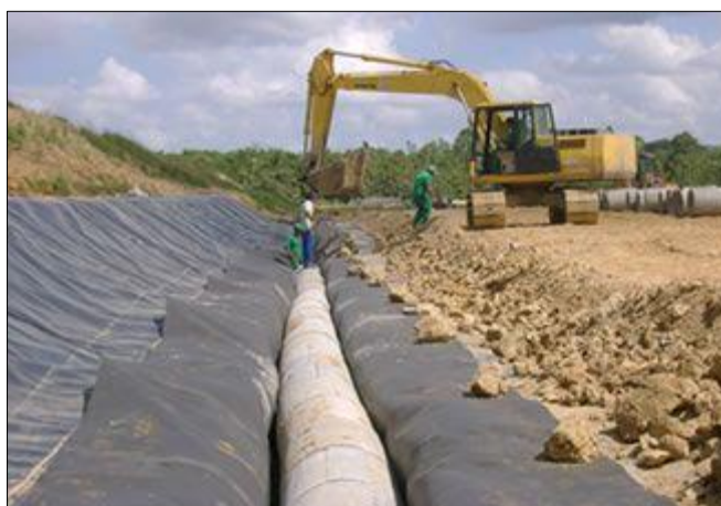
Foto 10 - Drenagem de líquidos percolados e gases no aterro da RAC Saneamento.
